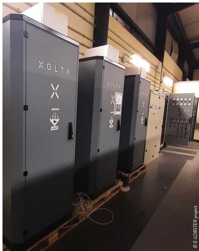
Figura 4: Sistema de batería modular de balance de litio (XOLTA)
