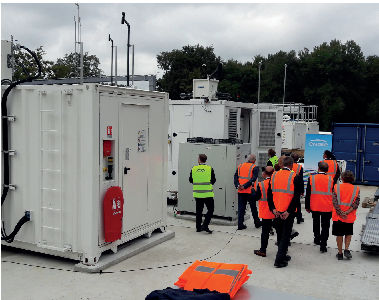
► Estações de Abastecimento de Hidrogênio. Pau, França
